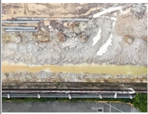
动态排水沟运行情况
