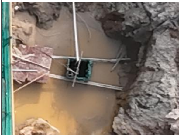
动态集水井运行情况
