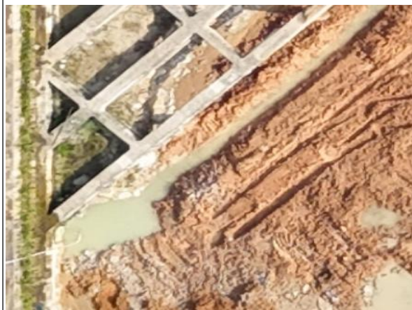
动态排水沟与动态集水井运行情况
