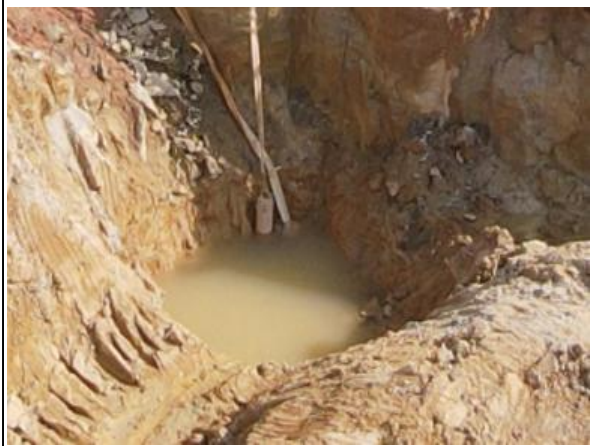
动态集水井运行情况
