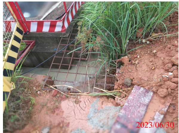
单级沉沙池现状 2
