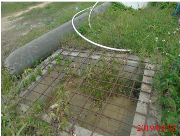
单级沉沙池现状 1
