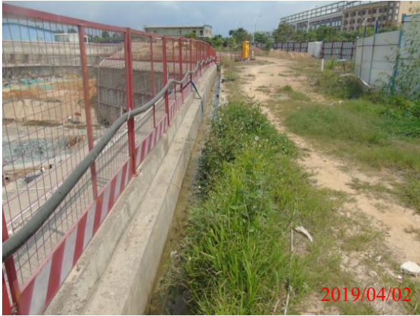
坑顶排水沟现状 1
