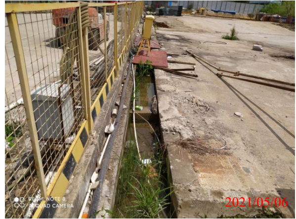
坑顶排水沟现状 2
