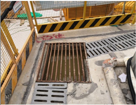
单级沉沙池运行情况
