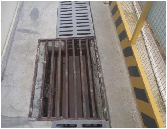
单级沉沙池运行情况
