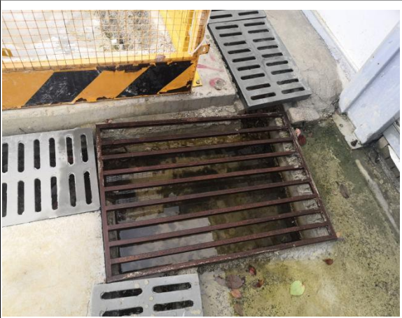
单级沉沙池运行情况
