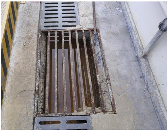
单级沉沙池运行情况
