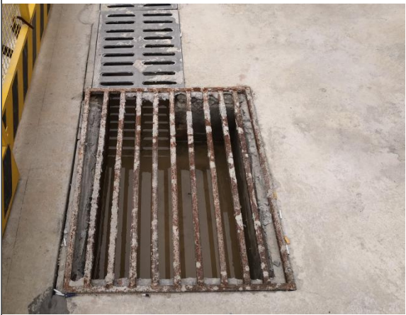
单级沉沙池运行情况
