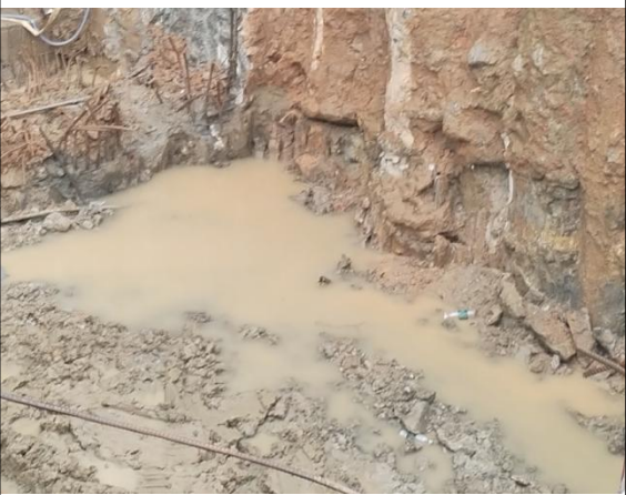
动态排水沟与集水井运行情况
