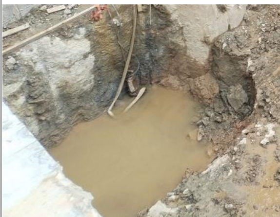
动态集水井运行情况
