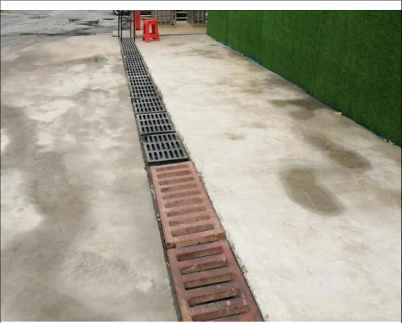
临时排水沟运行情况
