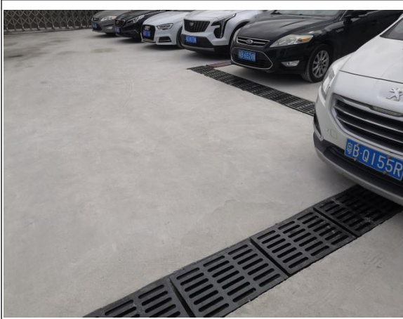
临时排水沟运行情况
