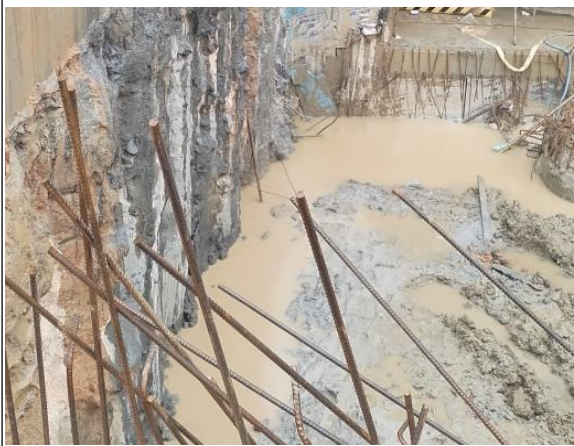
动态排水沟与集水井运行情况
