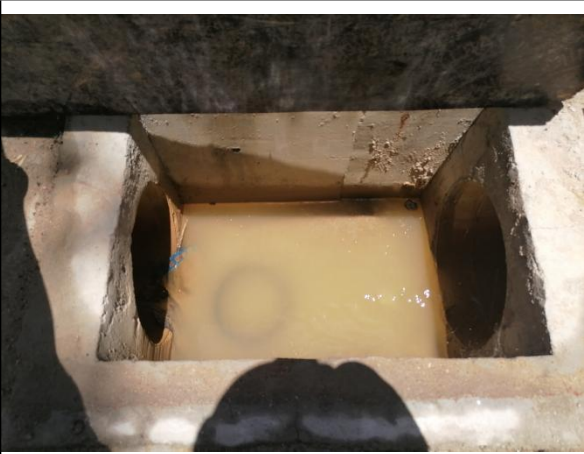
单级沉沙池运行情况
