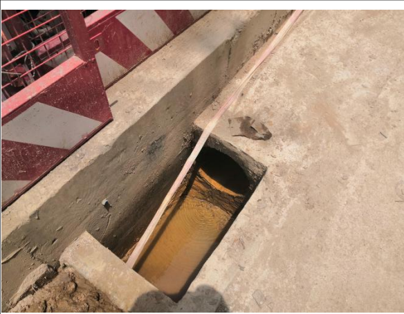
单级沉沙池运行情况
