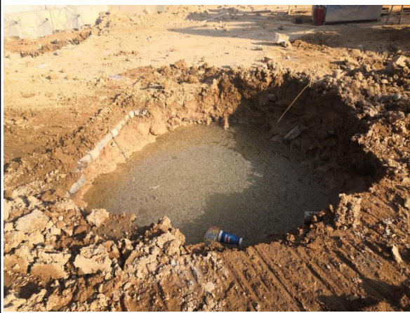
动态集水井运行情况
