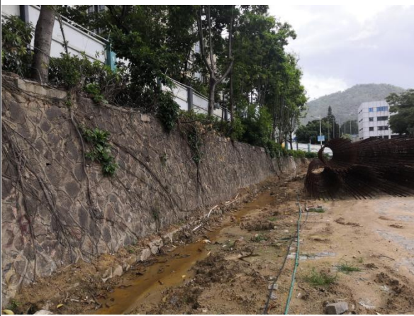
动态排水沟运行情况
