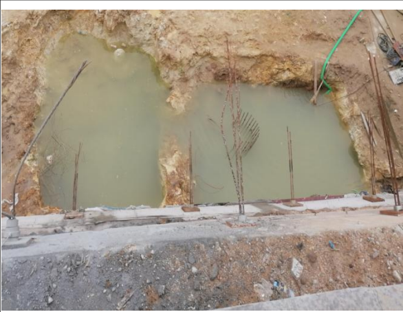
动态集水井运行情况
