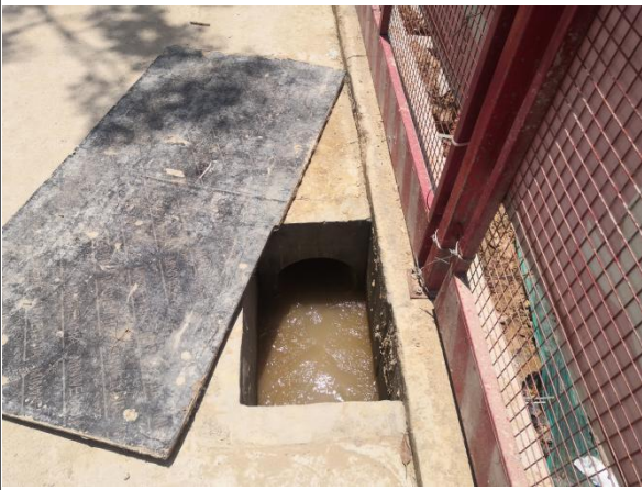
单级沉沙池运行情况
