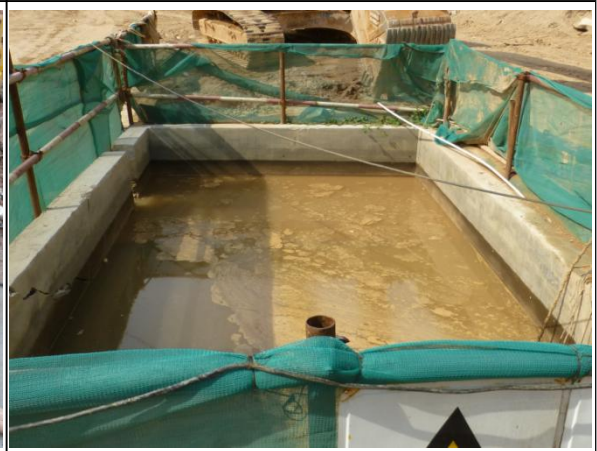
临时沉沙池运行情况
