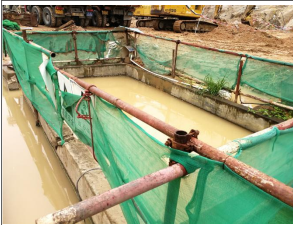
临时沉沙池运行情况
