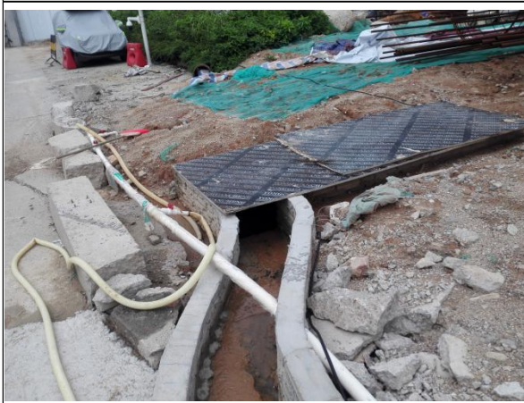
临时排水沟与沉沙池运行情况
