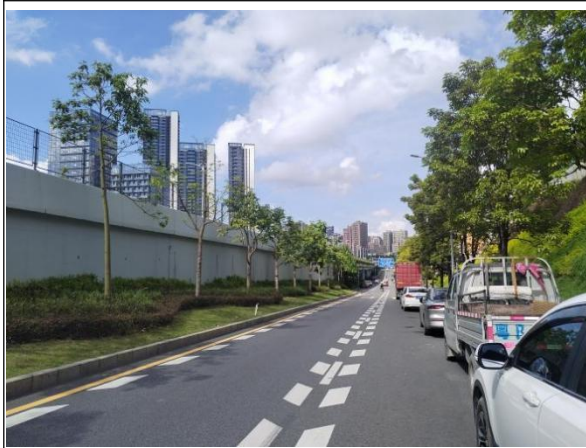
挡墙防护现状
