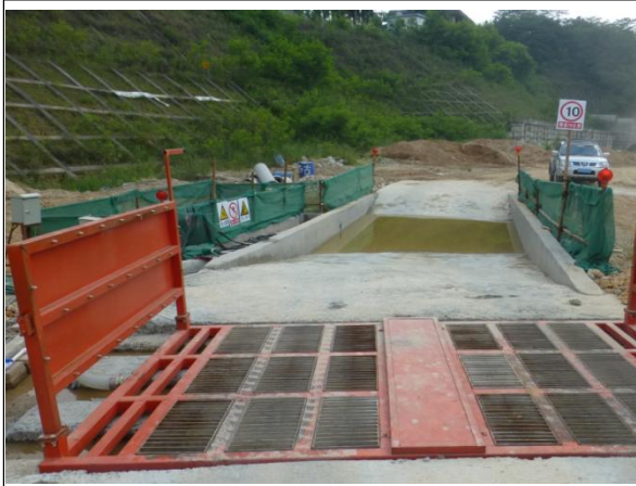
洗车设施运行情况
