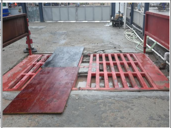
洗车设施运行情况
