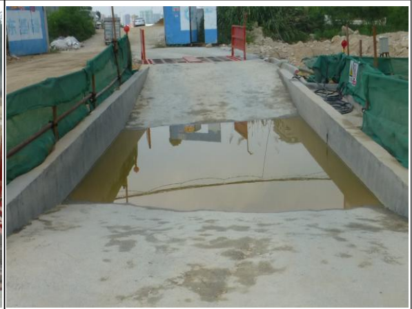
洗车设施运行情况
