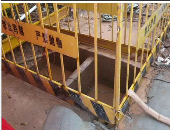
临时沉沙池运行情况
