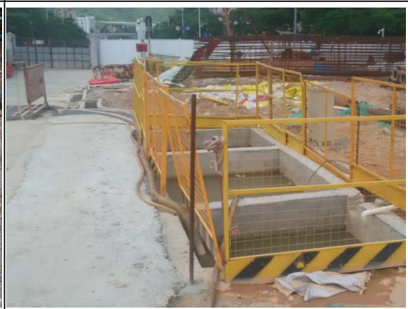
临时沉沙池运行情况
