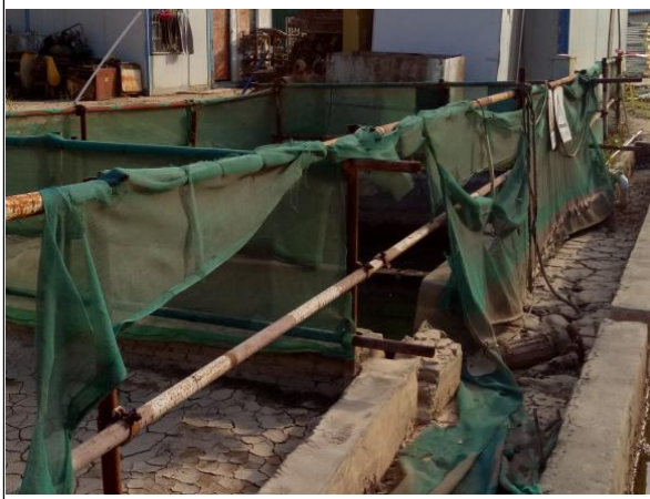
临时排水沟与沉沙池运行情况
