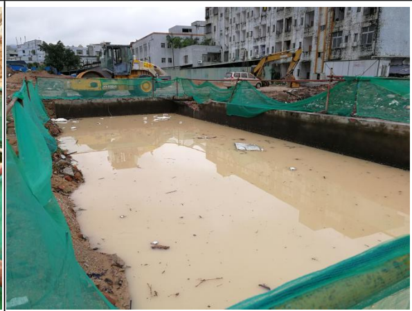
动态沉沙池运行情况
