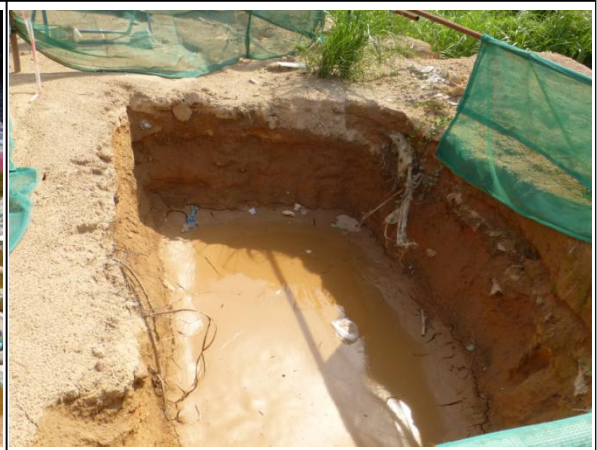
动态沉沙池运行情况
