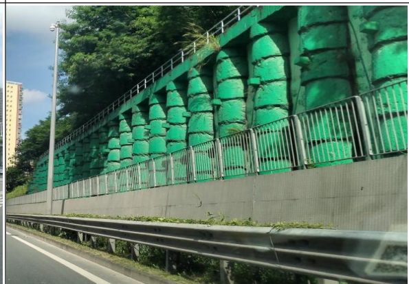
挡墙防护现状
