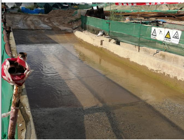
洗车设施运行情况
