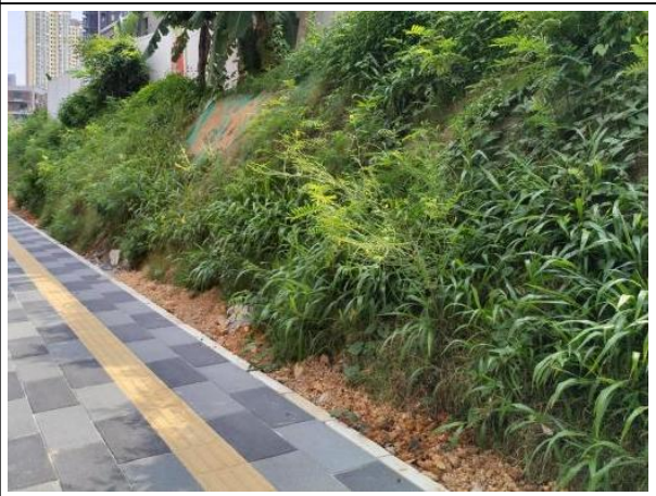
植草护坡现状
