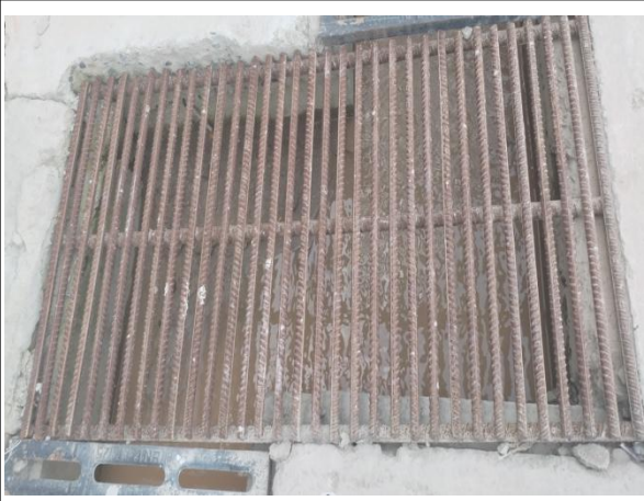
单级沉沙池运行情况
