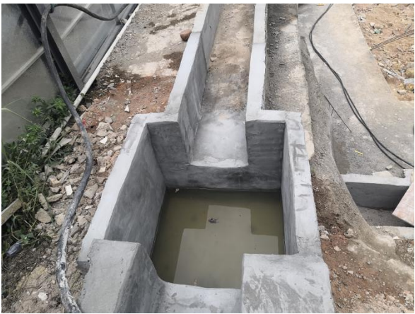
单级沉沙池运行情况
