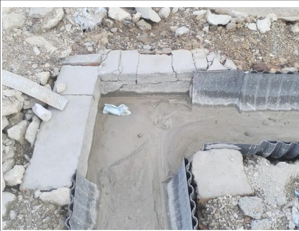
临时排水沟运行情况
