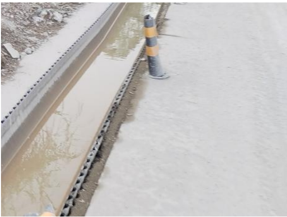
临时排水沟运行情况
