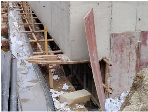
临时排水沟运行情况
