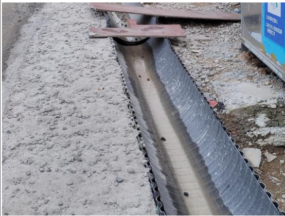
临时排水沟运行情况
