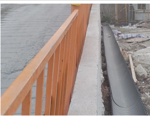
临时排水沟运行情况
