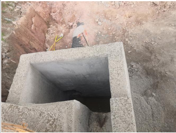
单级沉沙池运行情况
