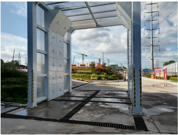
洗车设施运行情况
