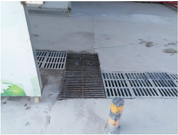
单级沉沙池运行情况
