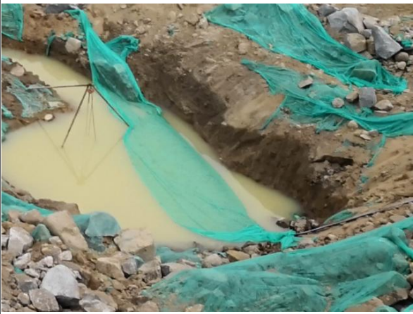
动态集水井运行情况
