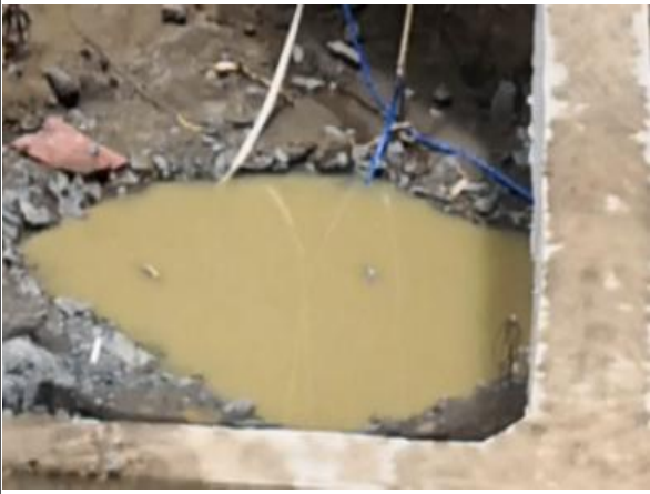
动态集水井运行情况
