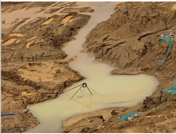
动态集水井运行情况
