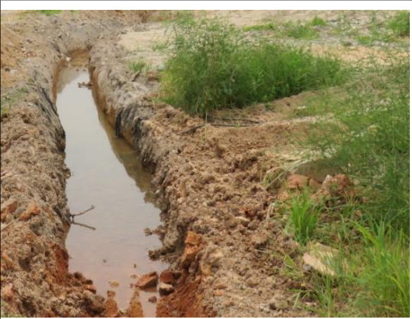
动态排水沟运行情况
