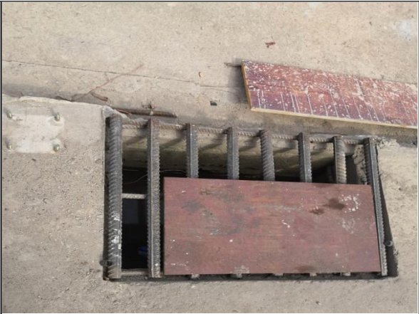
单级沉砂池运行情况
