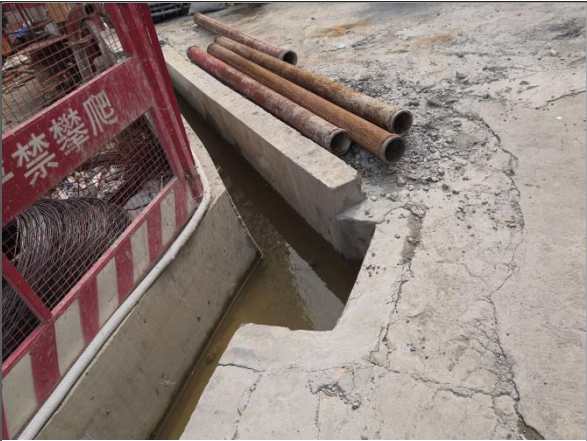
单级沉砂池运行情况
